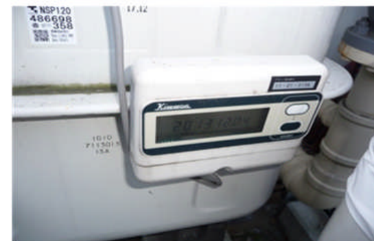
ボイラー(ガス量)
