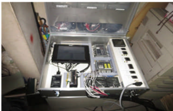
エネルギーモニタリング システム
