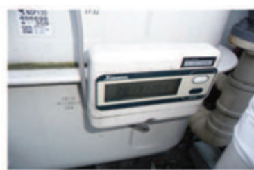
ボイラー(ガス量)
