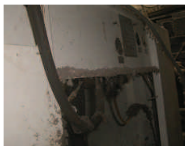
交換の必要なゴムホース
